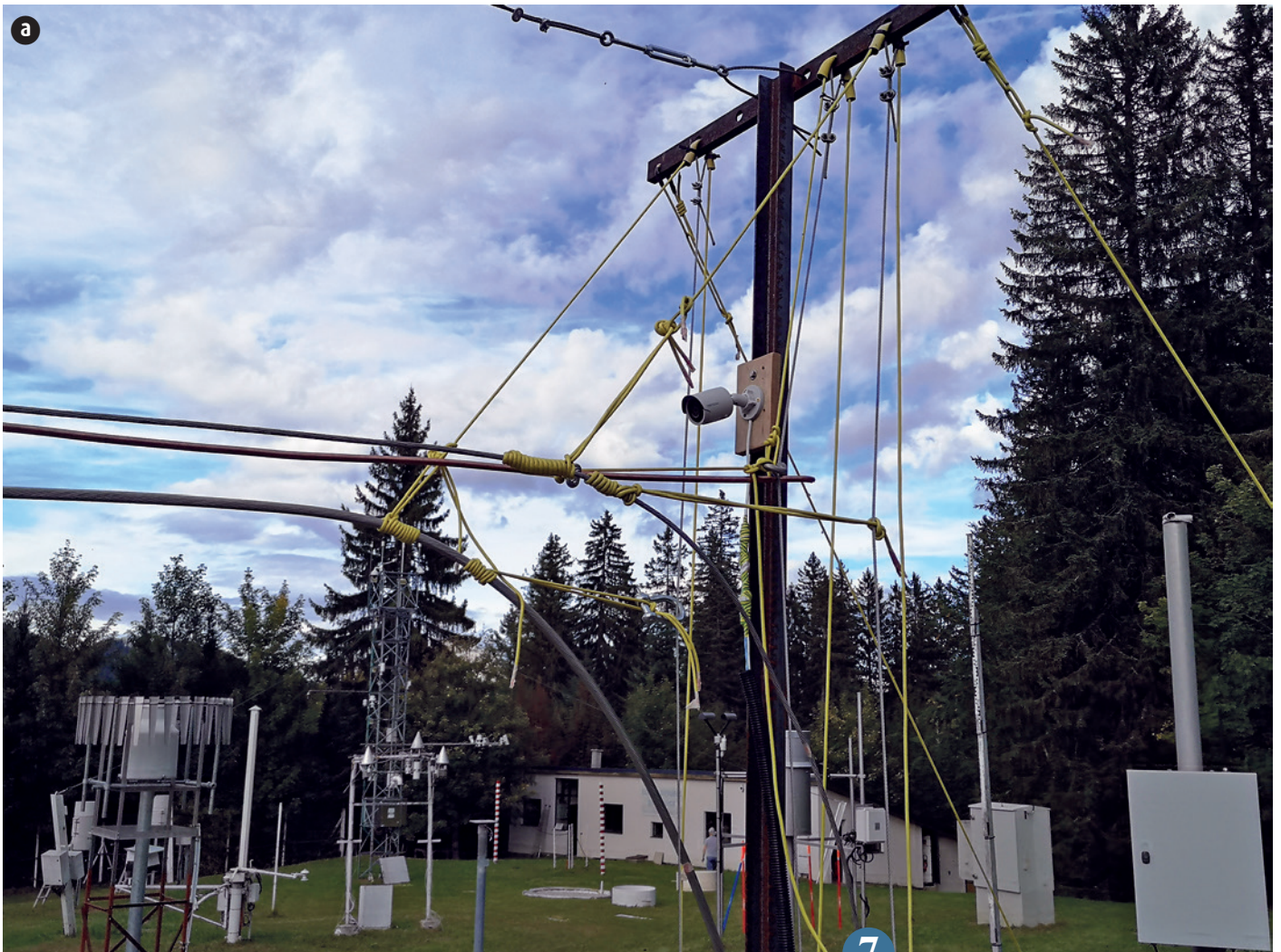
(a) Site instrumental d'observation des épisodes d'accrétion de givre et de neige sur les câbles aériens (câbles de transport d'électricité RTE et ENEDIS, caténaire SNCF) situé sur le site du Col de Porte.
